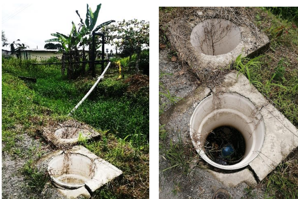
Ilustración 7 Tuberías del sistema de agua potable (obra paralizada)
